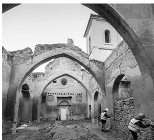
+ IGLESIA SAN LUIS Condición de ruina
