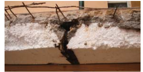
Vigüeta de voladizo con alta oxidación.
