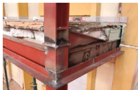
Izquierda. Estado del voladizo tras picado del zuncho de borde, con pérdida de sección de la vigueta de voladizo. Centro abajo. Refuerzo metálico de voladizos y zuncho de borde. Rigidización del nudo, y atado en vertical de toda la balconada, para rigidizar el conjunto.
